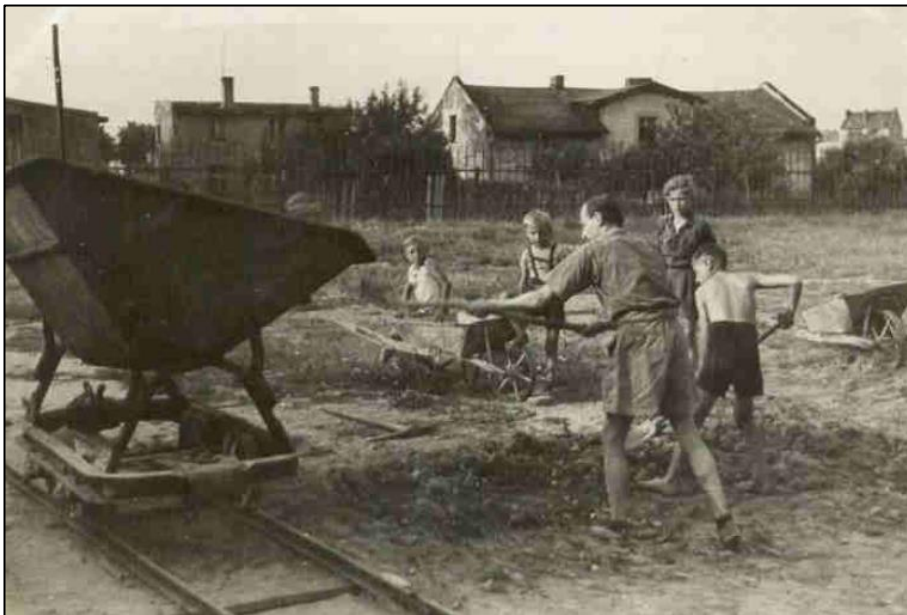
Fot. 12. Harcerze niwelują teren pod budowę Domu Harcerza. W tle dom rodzinny dh Teodora Krügera na ul. Bonin.
